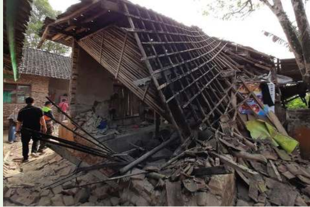
Gambar 1.8 Sejumlah rumah di Kecamatan Mandalawangi, Kabupaten Pandeglang rusak akibat gempa Banten
