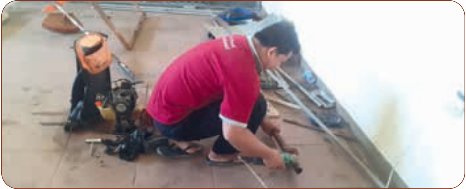
Gambar 4.10 Kondisi Kerja Tidak Aman
