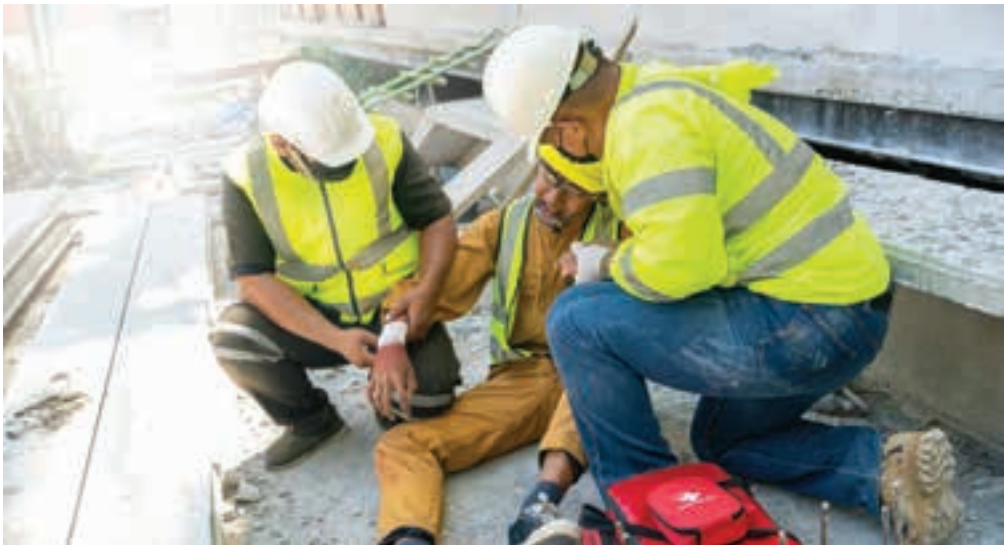
Gambar 2.2 Kecelakaan kerja di tempat konstruksi (Sumber: twlglawfirm.com, 2022)
