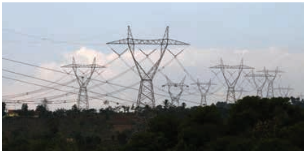
Gambar 1.6 Saluran Transmisi Sumber: PLN/Ahmad Hidayat (2018)
