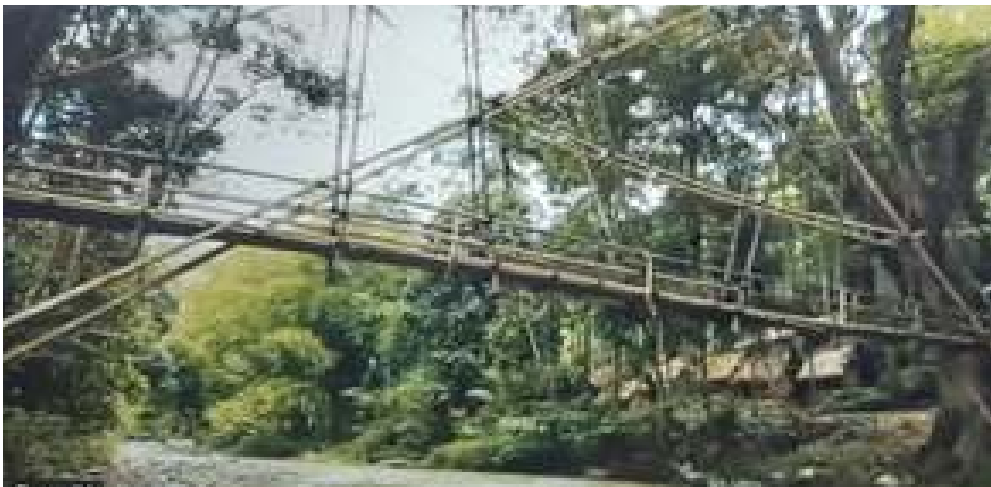
Gambar 10.2. Jembatan bambu yang merupakan kearifan lokal teknologi pembuatan sarana jalan dari daerah
