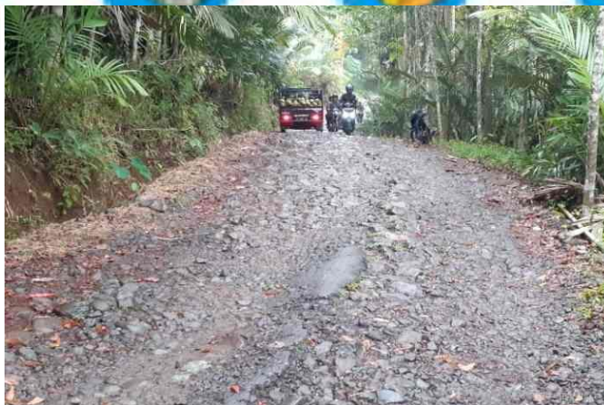
Gambar 3. Kondisi jalan menuju desa ngasinan yang rusak parah membuat kendaraan harus lebih berhati-hati saat melintas. (Sigit Rahmanto/ Jawa Pos Radar Semarang)
