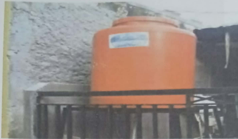
TANGKI Penampungan Air
