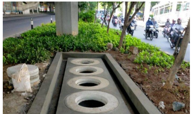
Sumur Resapan di jalan/taman
