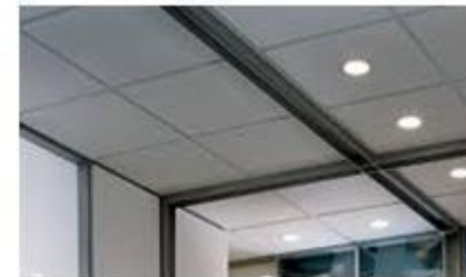
Plafon eternit atap
