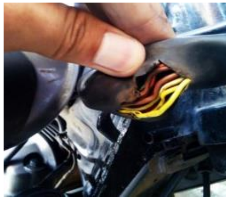
Gambar 56. Contoh kabel bodi yang rusak mengelupas
