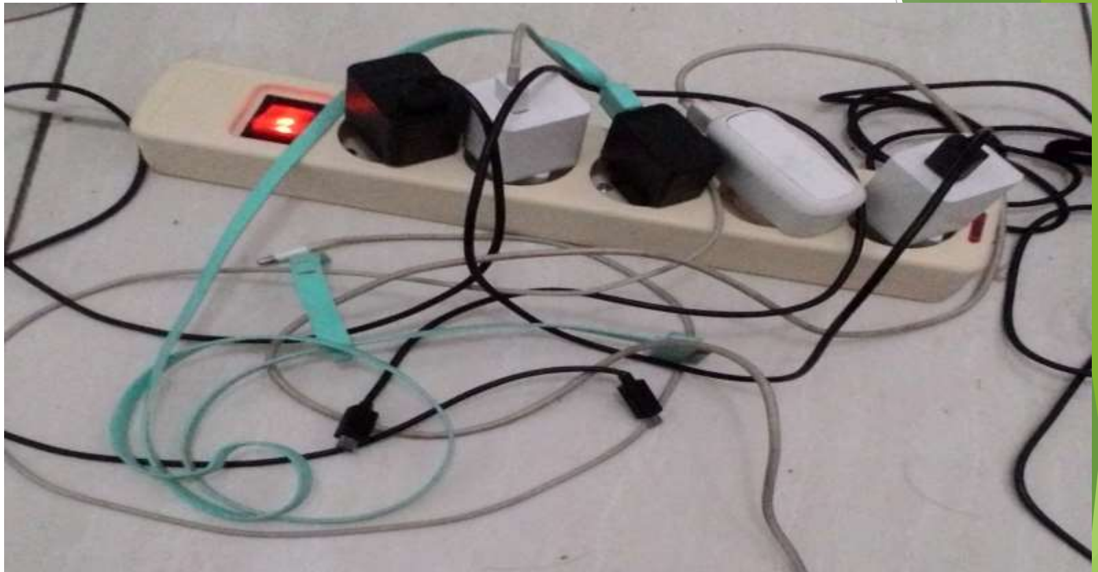
Gambar charger yang tidak dicabut setelah selesai digunakan
