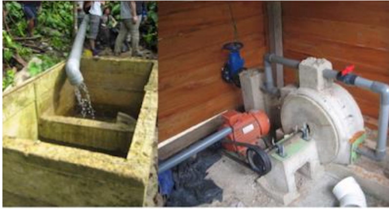
Pembangkit Listrik Tenaga Mikro Hidro (PLTMH)
