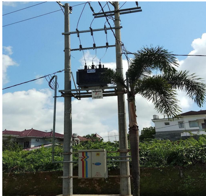
Gardu Distribusi (Tiang)
