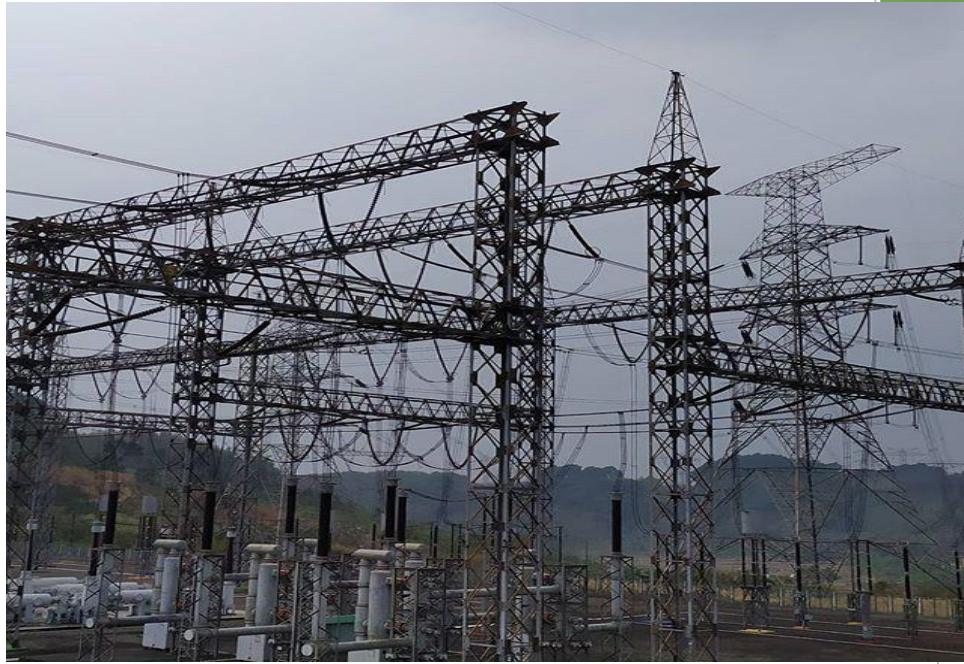
Gardu TET (Tegangan Ekstra Tinggi) Sumber foto : https://www.anakteknik.co.id
